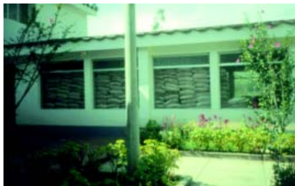
Figura 1-32. Ventanas mal ubicadas
