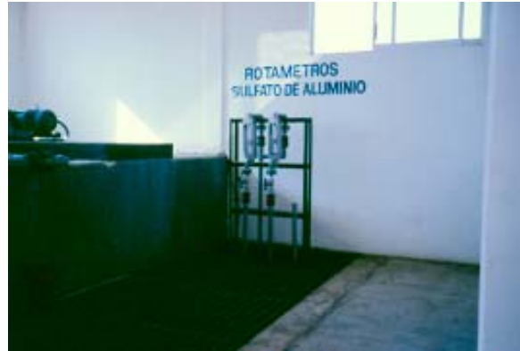
Figura 1-17. Sistema de dosificación por bombeo (I)
