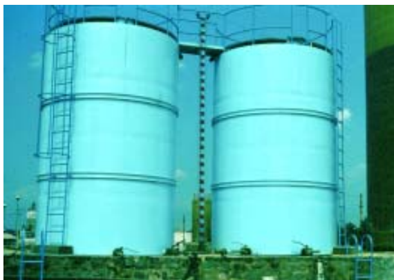
Figura 1-8. Tanque de almacenamiento de sulfato de aluminio líquido (1)
