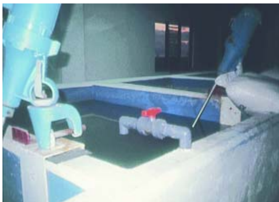
Figura 1-19. Tanque de preparación de la solución (1)
