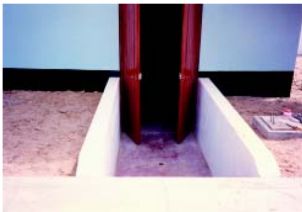
Figura 1-29. Almacén mal ubicado (1)
