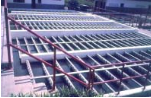
Figura 3-6. Floculador con pantallas de asbesto-cemento onduladas (7)
