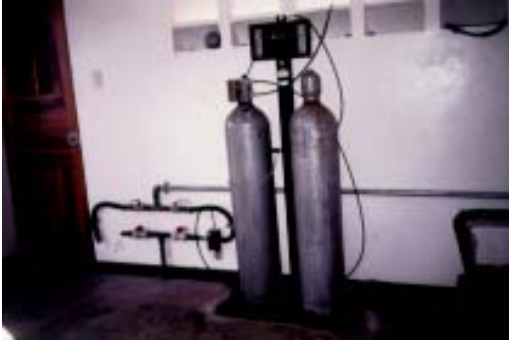
Figura 6-44. Sala de cloración mal ventilada (2)
