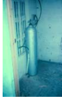
Figura 6-45. Sala de cloración incompleta (2)
