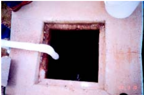
Figura 6-47. Entrada de una cámara de contacto de cloro (2)
