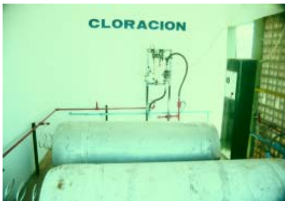
Figura 6-42. Sala de cloración defectuosa (2)
