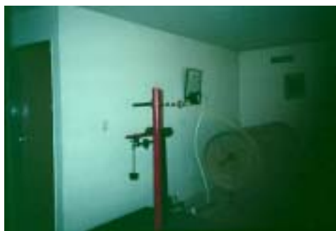
Figura 6-43. Sala de cloración mal instalada (2)
