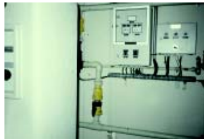
Figura 6-34. Sistemas de protección (2)
