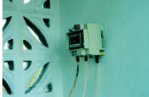
Figura 6-40. Falta un clorador alterno (2)
