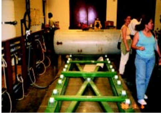
Figura 6-3. Almacén de cloro cerrado con ventilación artificial (2)
