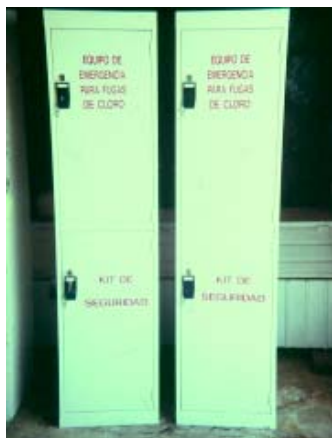
Figura 6-37. Armarios con el equipo para atención de fugas (2)
