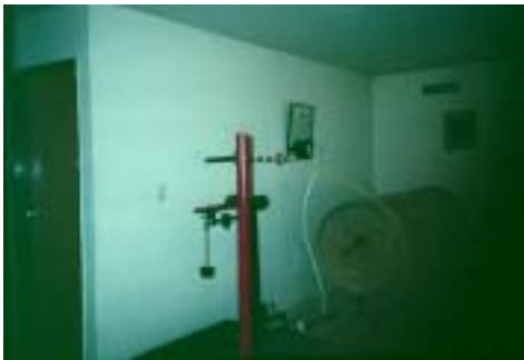
Figura 6-41. Sala de cloración mal ubicada e instalada (2)
