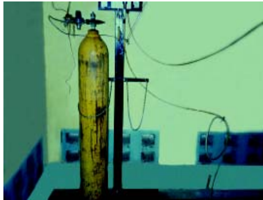
Figura 6-17. Clorador de aplicación directa a una tubería (2)
