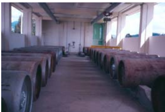
Figura 6-2. Almacén de cloro abierto para cilindros de una tonelada (2)
