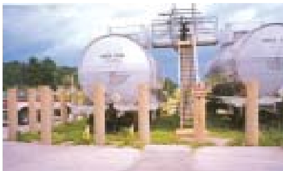
Figura 6-1. Contenedores de cloro expuestos al Sol (2)
