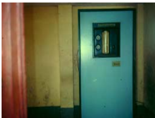
Figura 6-39. Falta un clorador alternativo (2)
