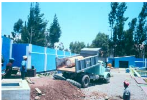
Figura 6-48. Descarga inadecuada de cilindros de cloro de una tonelada (2)
