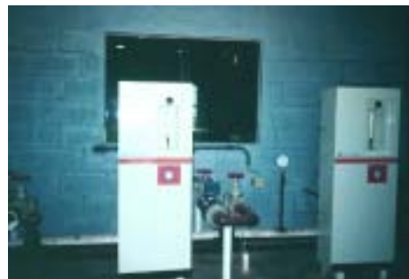
Figura 6-26. Cloradores de consola (2)
