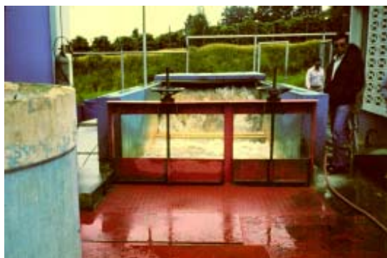
Figura 2-7. Mezclador de tipo rampa en una planta grande (4)
