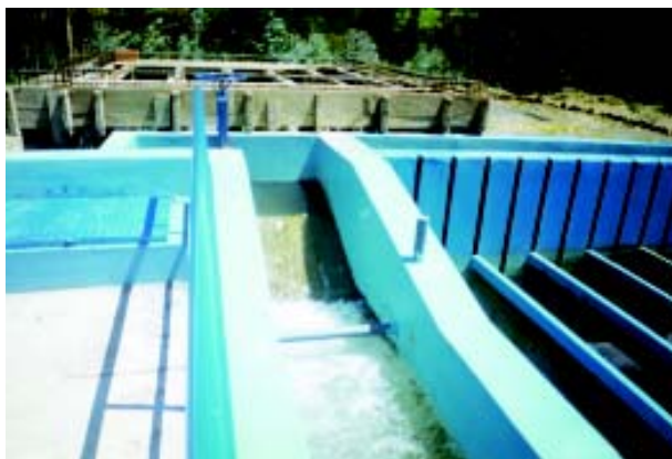
Figura 2-4. Mezclador del tipo rampa en una planta mediana (4)
