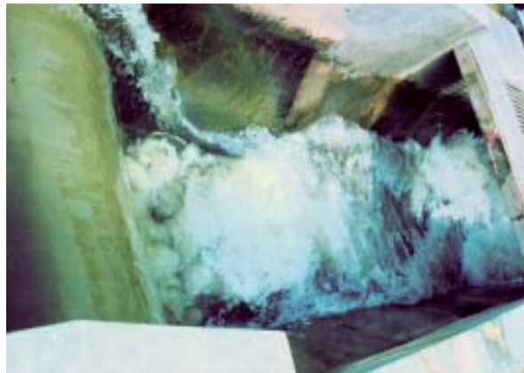
Figura 2-13. Canaleta Parshall defectuosa (4)
