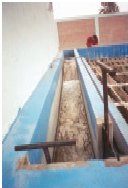
Figura 2-9. Defectos en el canal de aproximación a la rampa (4)
