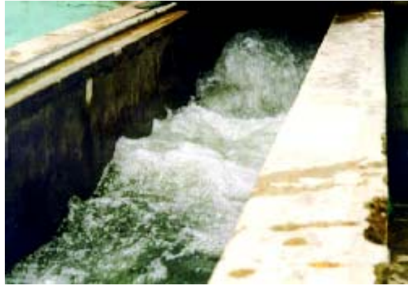
Figura 2-16. Canaleta Parshall mal ubicada (4)
