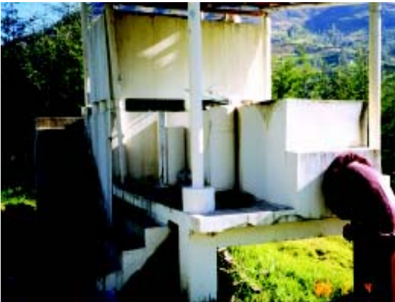
Figura 2-17. Canaleta Parshall contrahecha (4)
