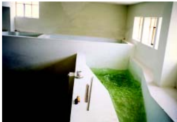
Figura 2-19. Canaleta Parshall defectuosa (4)
