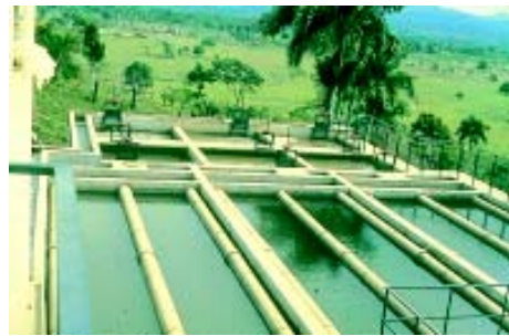
Figura 4-35. Sistema de recolección mal instalado (4)
