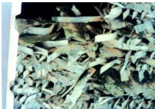
Figura 4-3. Módulos de decantación de plástico deteriorados (4)
