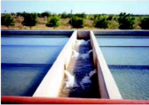
Figura 4-33. Decantador de placas con problemas de recolección (4)
