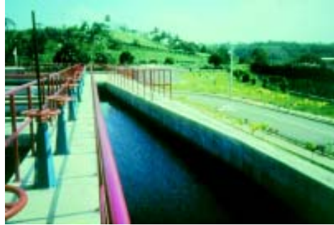
Figura 4-5. Canal de distribución a varios decantadores (4)
