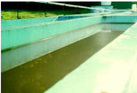
Figura 4-34. Decantador de placas sin sistema de recolección apropiado (4)
