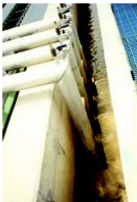
Figura 4-29. Canal de descarga del sistema CLARIVAC
