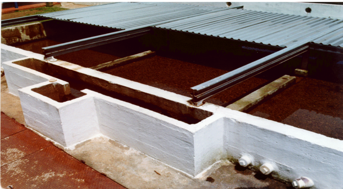
Figura 9.3 Filtro grueso ascendente en capas con tres unidades en paralelo. La cubierta removible contribuye a disminuir el crecimiento de algas y a facilitar el mantenimiento de las unidades. Parcelación El Retiro, Cali, Colombia, 1997.
